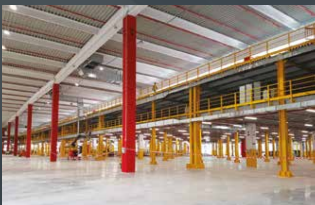
Struttura metallica Magazzino logistica (Roma)
