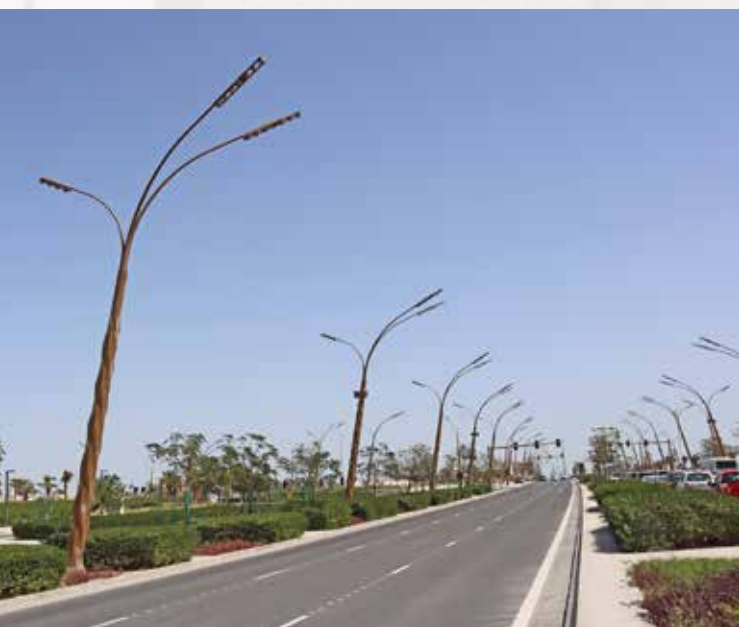
Torri illuminazione RAL 1036 Khalifa Avenue (Doha, Qatar)
